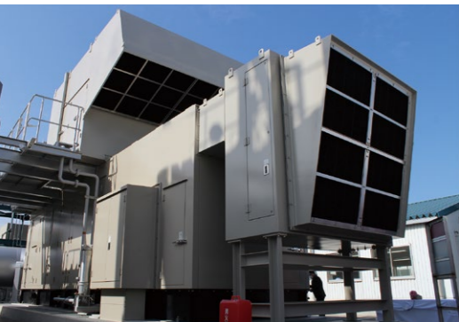
千葉工場の自家発電設備
