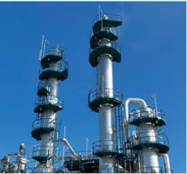
千葉工場 CO 2 回収装置
